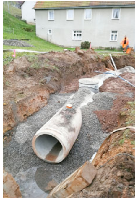
verrohrter Teil des Baches
