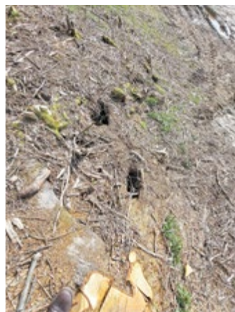
Der schadhafte, durchlöcherzte Zustand zu Beginn der Maßnahme
